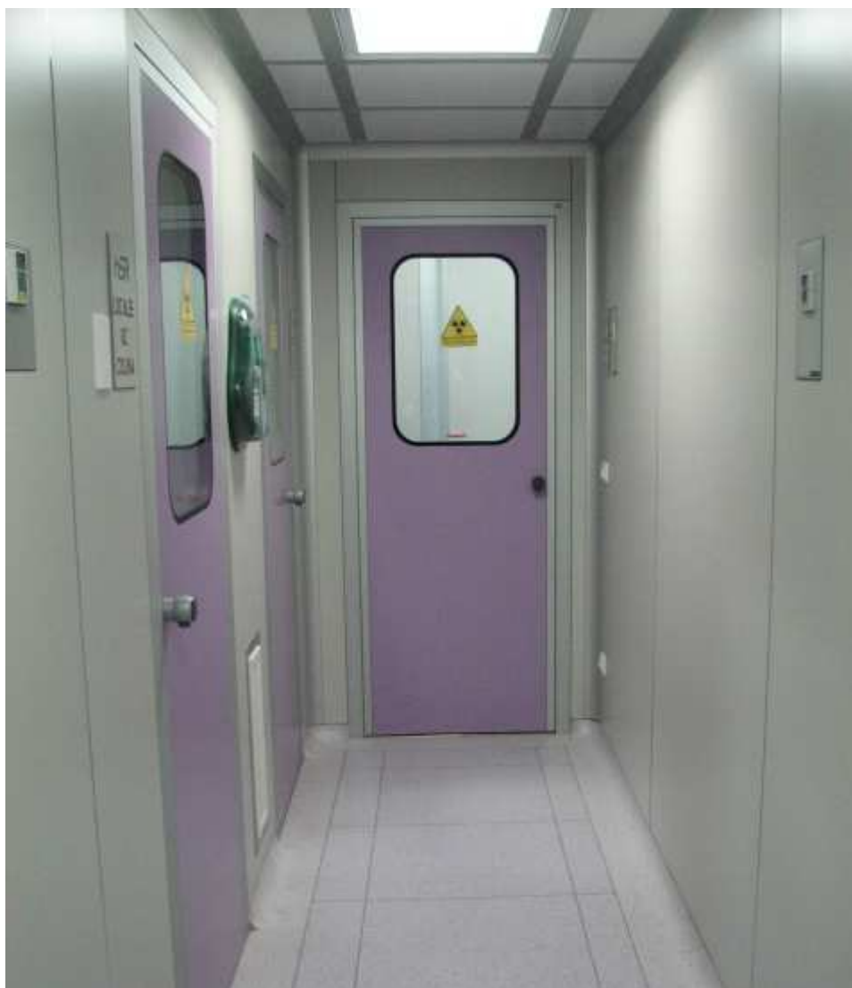
Fig. 35. Nuova Radiofarmacia- Corridoio della classe C con accesso ai laboratori di sintesi.
